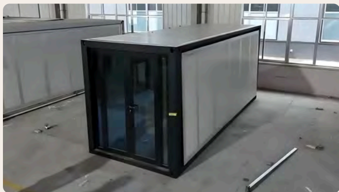
1. Подготовка базового блока к установке Дом прибывает на площадку в полностью сложенном виде.
